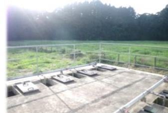
鶴ヶ台牛舎 排水処理施設
