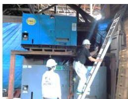
予備発電装置の稼働訓練
