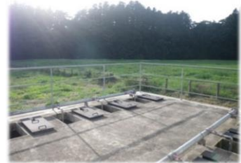
鶴ヶ台牛舎 排水処理施設
